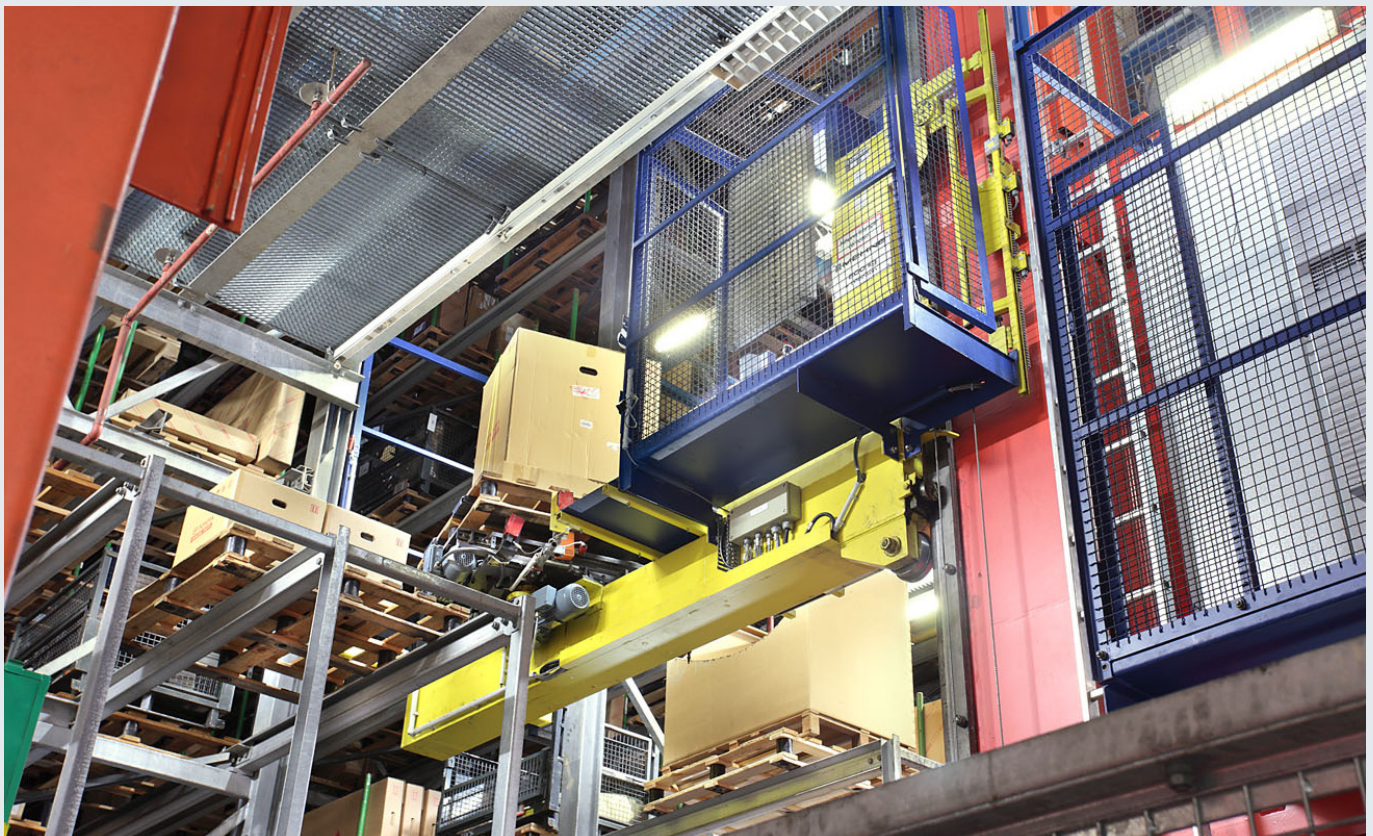
Die Hubwagen erhielten neue Positionierungssysteme und Kamerasysteme zur Überwachung der Lastaufnahme. Die langsamen und ineffizienten Antriebe wurden gegen frequenzgeregelte Motoren mit geringem Stromverbrauch ausgetauscht.
