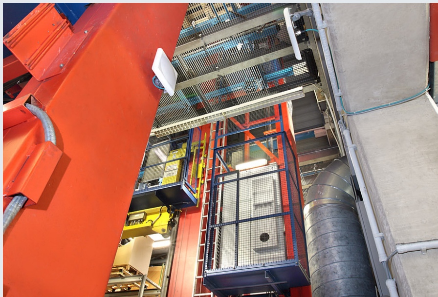
Wesentliche Teile der bestehenden Anlage konnten erhalten bleiben, so auch die Masten der Regalbediengeräte. Auf halber Höhe wurden die Antennen für die neue WLAN-Datenübertragung installiert.
