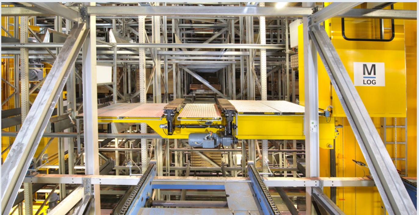
Vor dem Regalfach kommt es auf jeden Millimeter an – dank der hochgenauen Positionierung der installierten Antriebstechnik konnte auf eine Fachfeinpositionierung verzichtet werden (rechts).
