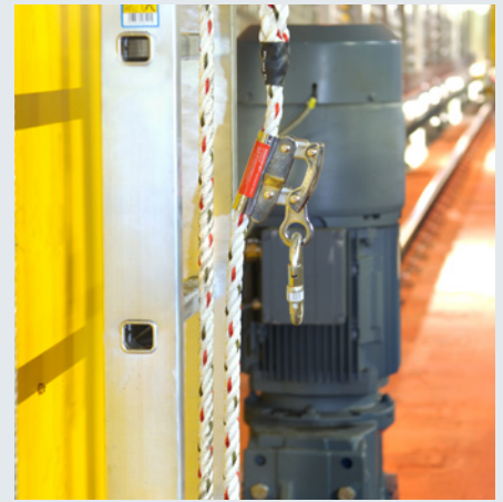
Die RBG sind mit frequenzgeregelten Drehstrom-Aggregaten ausgestattet, so dass sich die Geschwindigkeiten stufenlos regulieren und kurvenoptimiert betreiben lassen – auch aus energetischer Sicht ein Vorteil.
