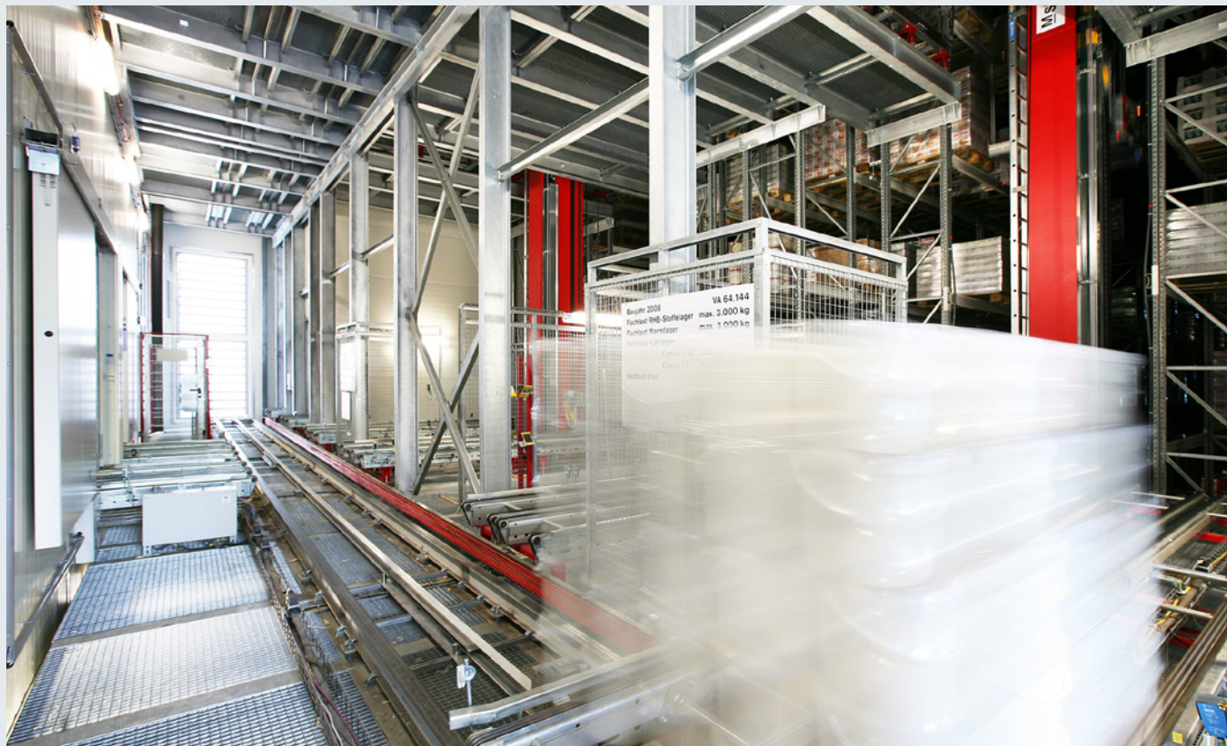
Die Euro- bzw. Düsseldorfer Paletten werden durch die vier RBG in 75 Meter langen Gassen eingelagert.
